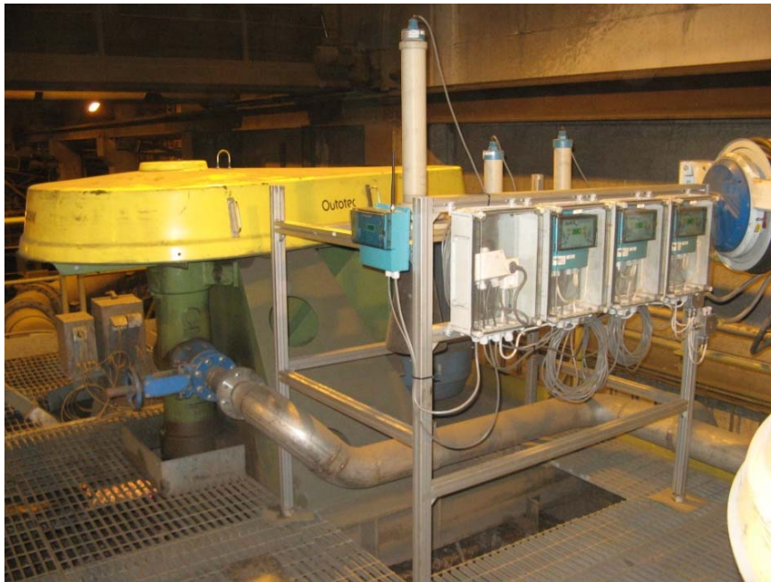
Figura 5. Medidores instalados in-loco.
