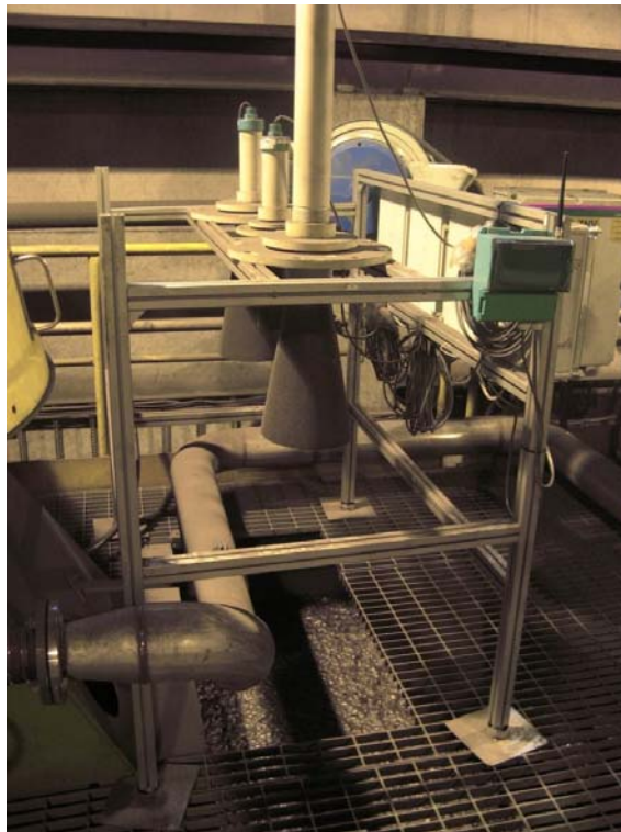
Figura 6. Medidores instalados in-loco.
