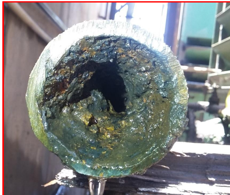
Figura 3 – Tubulação de água com incrustação severa
