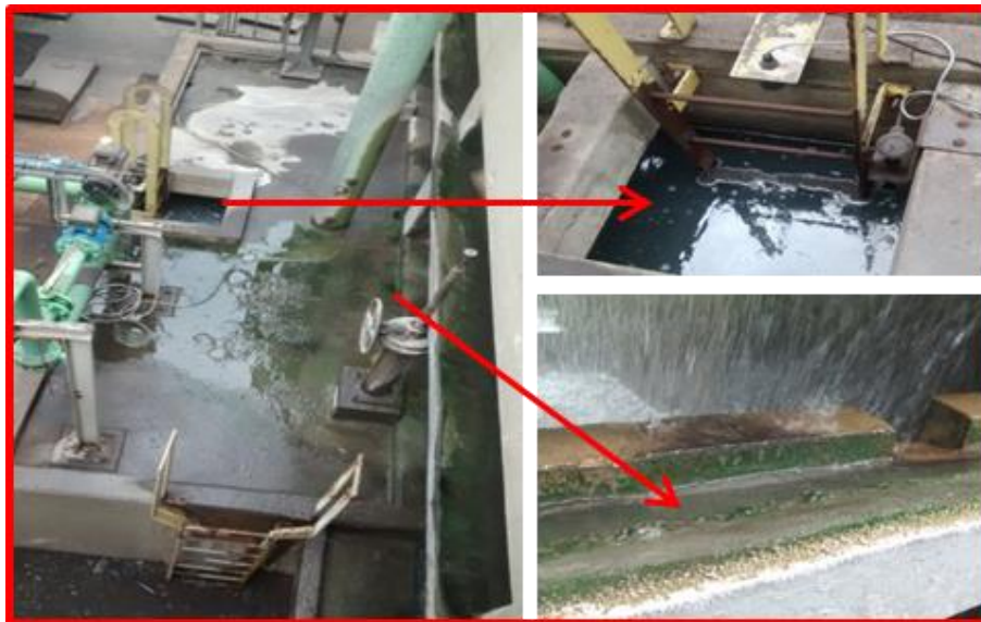
Figura 5 - Torre de Arrefecimento – Formação limo e turbidez da água de condensação evidenciando falha no tratamento químico aplicado.
