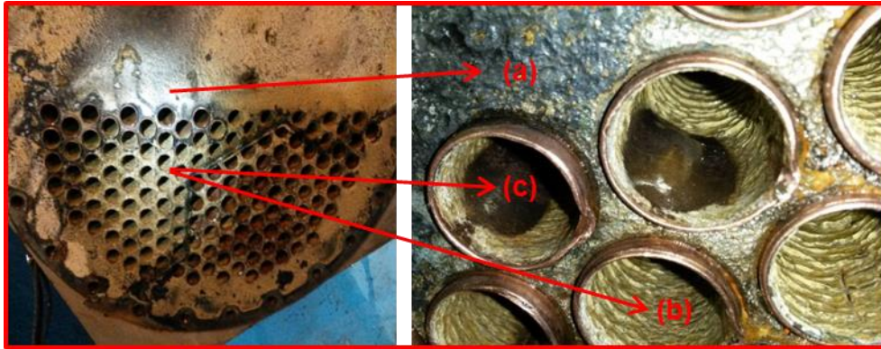
Figura 4 - Condensador do Chiller nº2 do LTQ: Apresentando corrosão no espelho (a), incrustação nos tubos(b) e deformação interna no tubo (c), após tentativa de limpeza com alta pressão, devido a deficiência no tratamento da água da torre no processo convencional.
