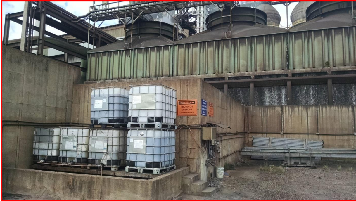
Figura 2 – Estação de dosagem de Produtos Químicos
