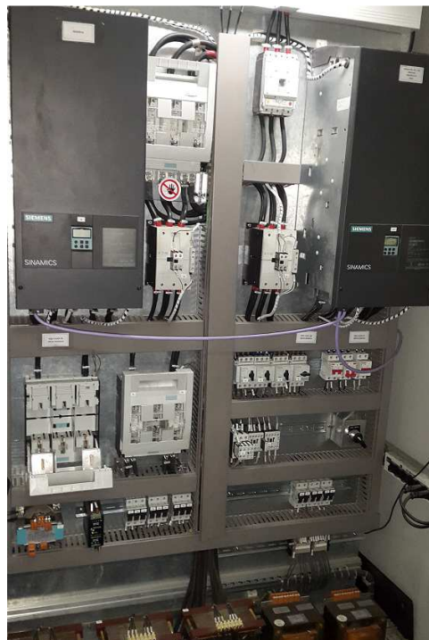
Figura 10. Drives de Armadura
