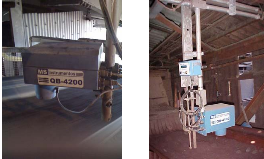
Figura 4. Analisador NIR instalado em Siderurgias.
