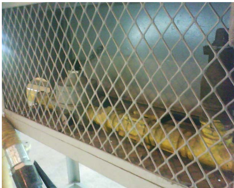
Figura 5 – Manifold com suas válvulas de segurança.
