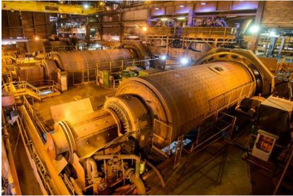
Figura 2. Moinhos de bolas instalados na usina de pelotização Vale S.A.
