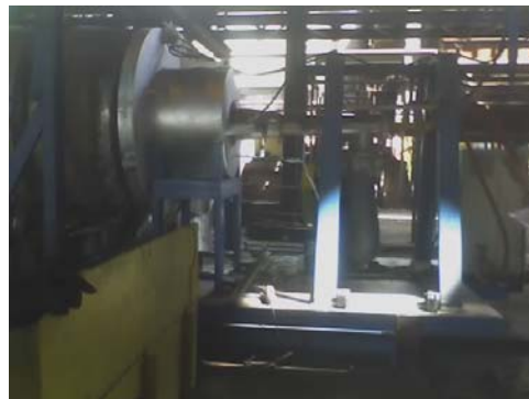
Figura 11. Foto da câmara de combustão do forno rotativo
