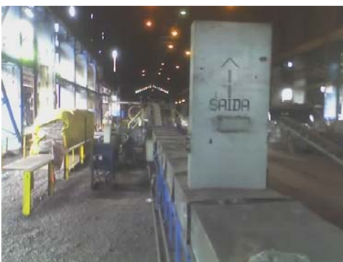
Figura 7. Vista longitudinal do forno secador
