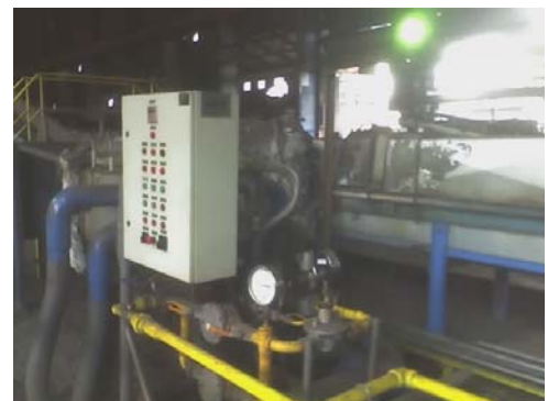
Figura 8. Foto do painel de controle e queimador do forno secador
