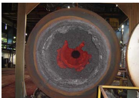
Figura 13. Formação de cascão no interior do forno
