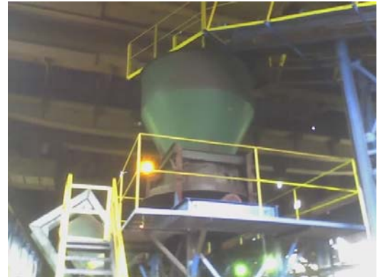
Figura 5. Foto do silo dosador
