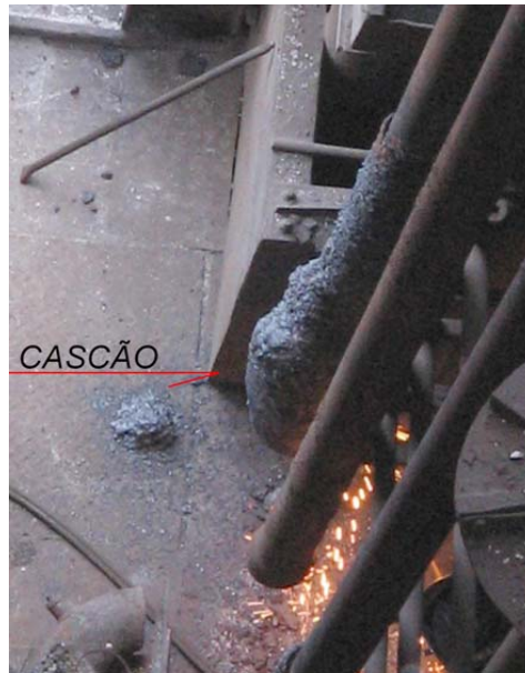
Figura 3. Fotografia onde são apresentadas duas lanças, sendo a primeira com cascão e a segunda já limpa, pronta para reutilização.
