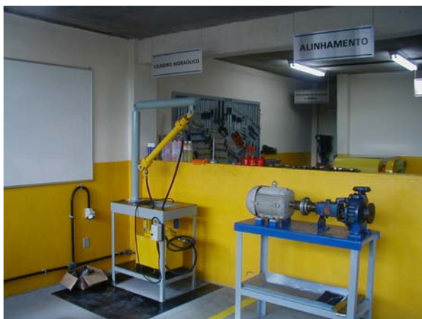
Figura 5. Unidade Hidráulica e equipamento para alinhamento
