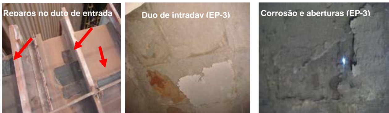
Figura 2. Amostras de pontos de corrosão nos dutos de entrada e saída dos Precipitadores
