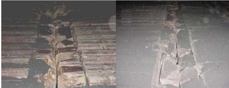
Figura 5 - Quebras de bordas da soleira e zonas de transição.
