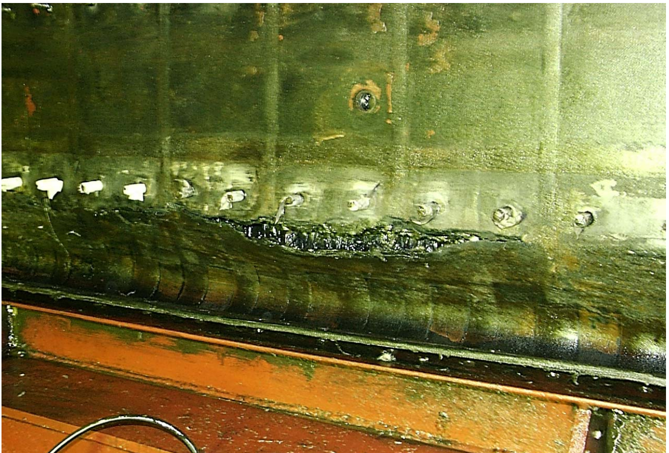
Figura 5. Estado de desgaste do avental da selagem. Necessidade de troca do componente.
