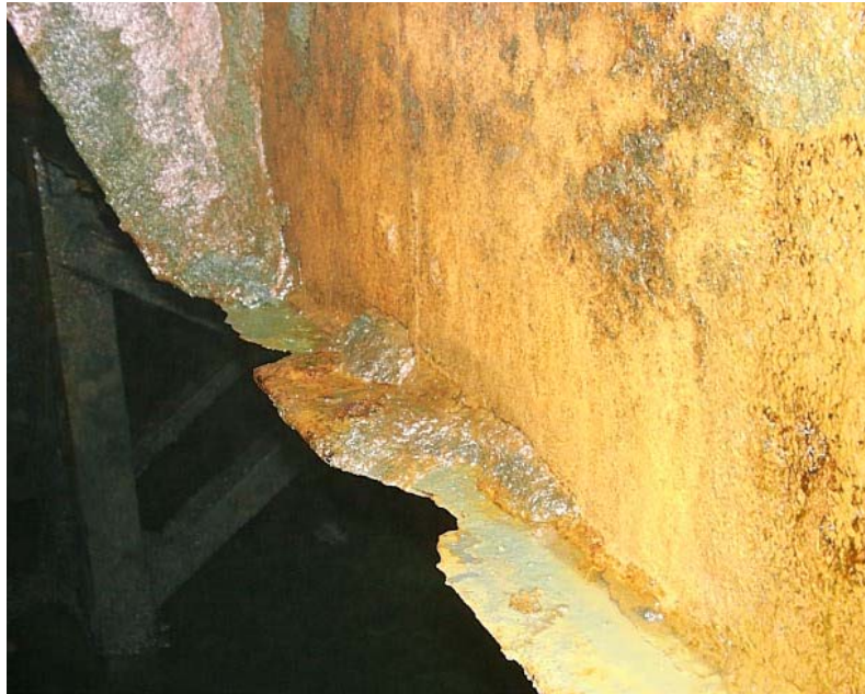
Figura 2. Corrosão na chaparia da caixa de sustentação . As chapas metálicas apresentam desgaste, redução de espessura e depósitos de material.
