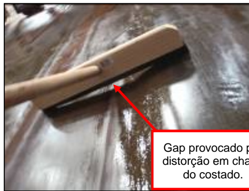
Figura 9. Distorção em chapas do costado.
