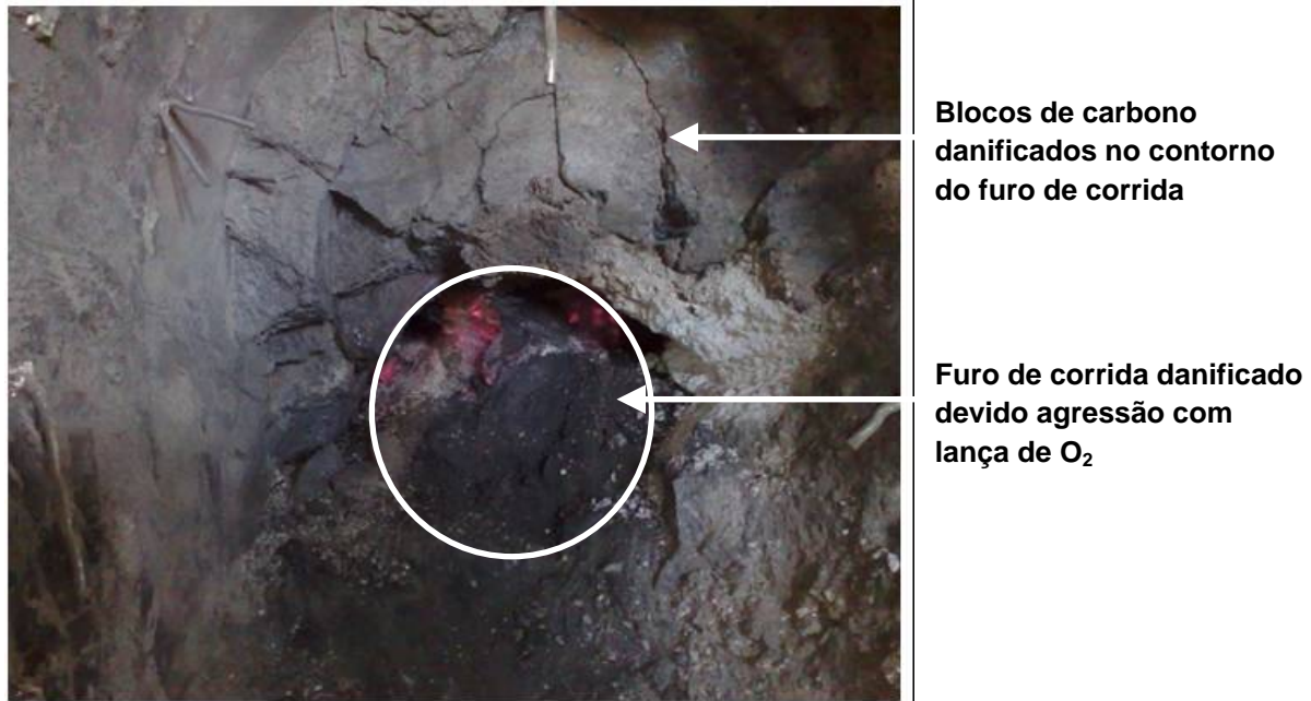
Figura 4. Desgaste acentuado dos blocos de carbono na região do furo de corrida. (3)
