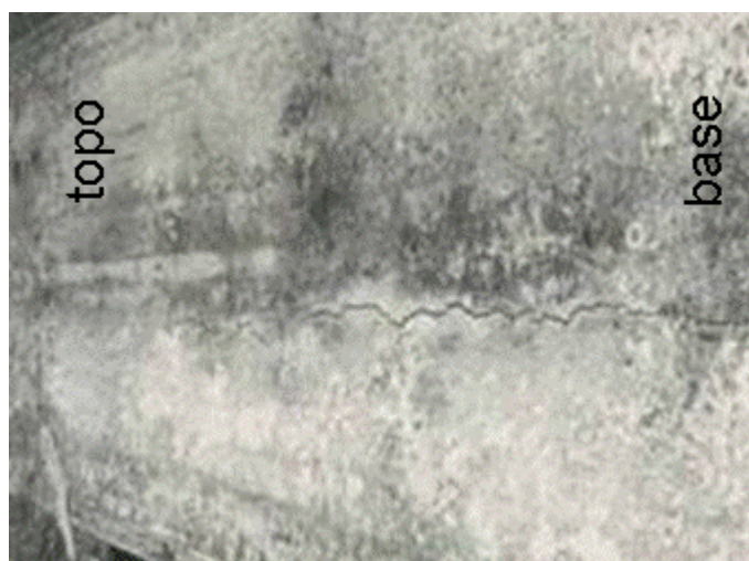
Figura 1 – Trinca superficial longitudinal. (2)
