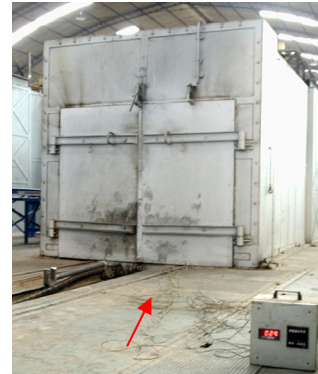
Figura 8b. Forno de tratamento térmico industrial.
