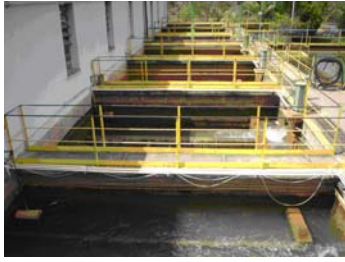
Figura 6. Vista geral dos Sete filtros
