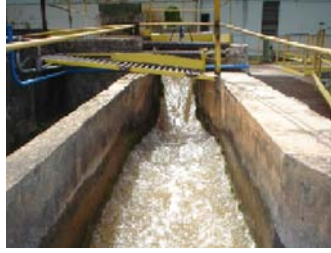
Figura 3. Caixa de chegada da água bruta
