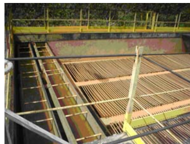
Figura 5. Vista do DEC 600 parado para limpeza
