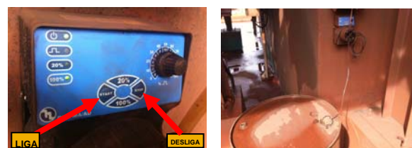
Figura 6. Sistema de dosagem com bombas dosadoras.
