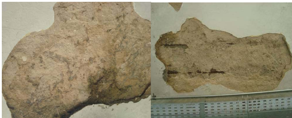
Figura 6. Patologia no reboco.
