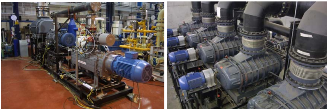
Figura 4: Instalação das bombas secas em indústrias de aço. (3)
