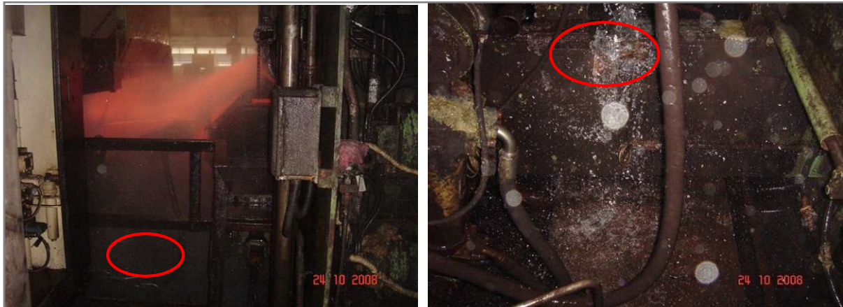
Figura 10. Local de instalação do sensor com a linha em operação, excesso de água e vapor atuando diretamente.
