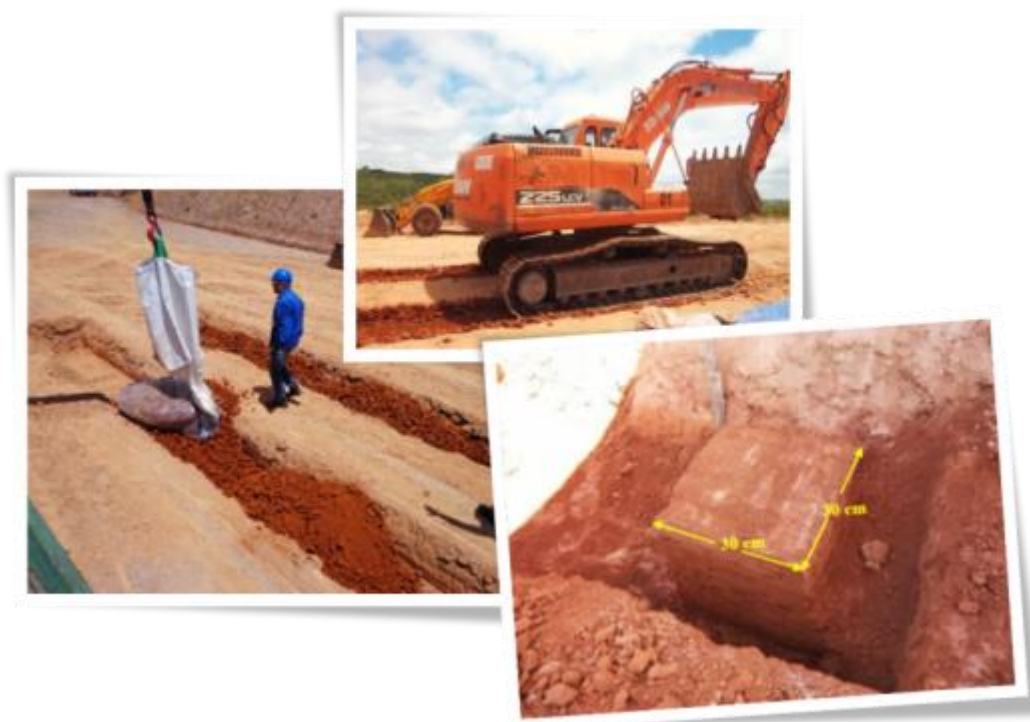
Figura 7 – Compactação extra, realizada passando uma escavadeira oito vezes sobre o trecho preenchido com resíduo.
