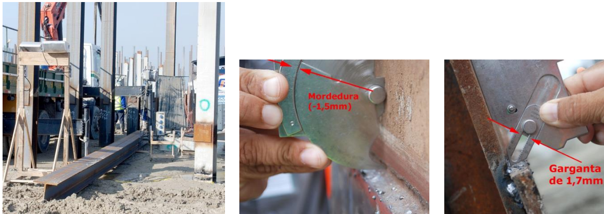
Figura 3. Caso de queda de viga durante operação
