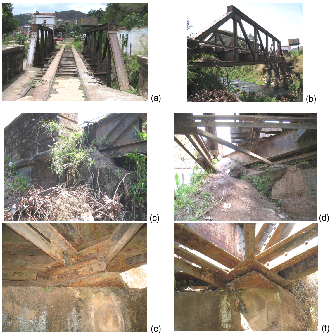
Figura 5 – Fotografias da “Ponte da Estação de Ouro Preto” destacando-se regiões do efeito do meio na corrosão da estrutura metálica; vistas: frontal (a) e lateral(b); sistema de apoio das cabeceiras (c) e (d); corrosão uniforme e por fresta: aparelho de apoio (e); detalhe de ligação do encontro (f).
