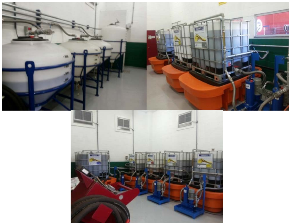
Figura 22. Tanques de sedimentação e conjuntos off-lines das 2 salas de tratamento.
