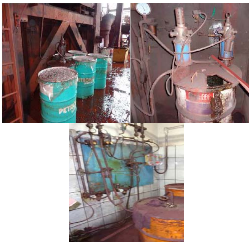
Figura 7. Condições das unidades de lubrificação
