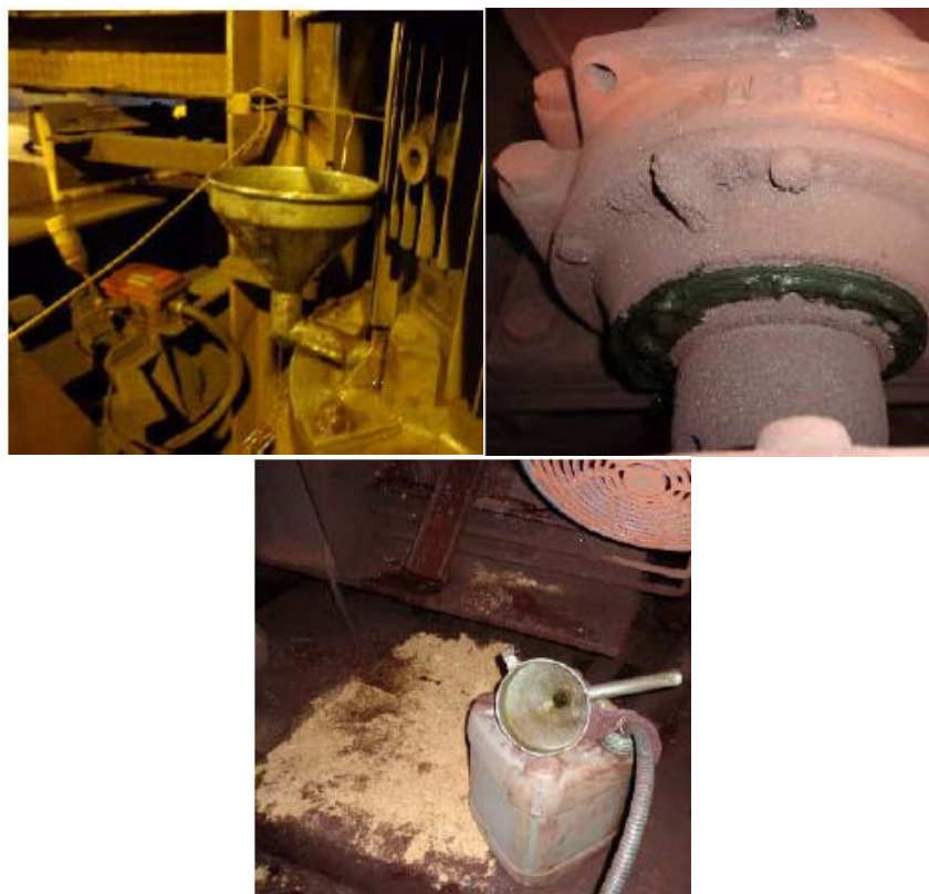
Figura 6. Funil em condições precárias, excesso de lubrificante e condições dos equipamentos de rotina.
