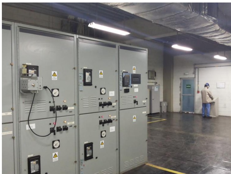
Figura 6. Extração remota do disjuntor.
