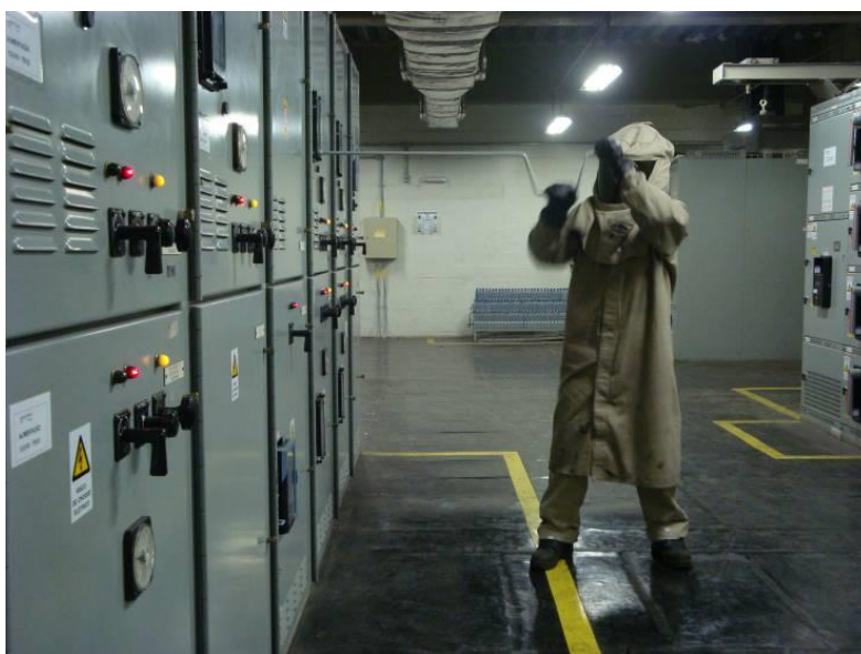
Figura 5. Extração manual do disjuntor.
