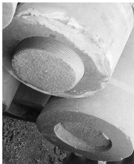
Figura 9 - Quebras de pinos fora da área da face de contato.
