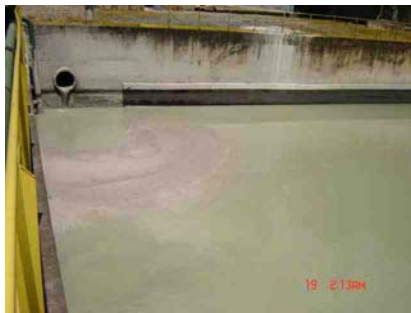
Figura 5 – Material decantado no tanque 701
