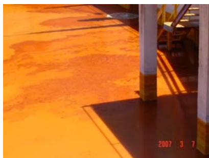
Figura 7 - Tanque 701 Detalhe da película de ferro oxidado
