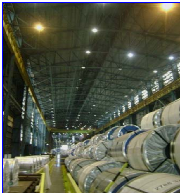
Figura 2. Vista da iluminação do galpão EE-09.
