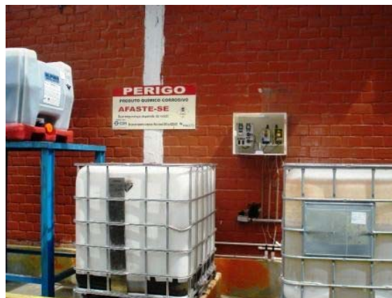
Figura 4- Dosagem de produtos em containers com bombas dosadoras
