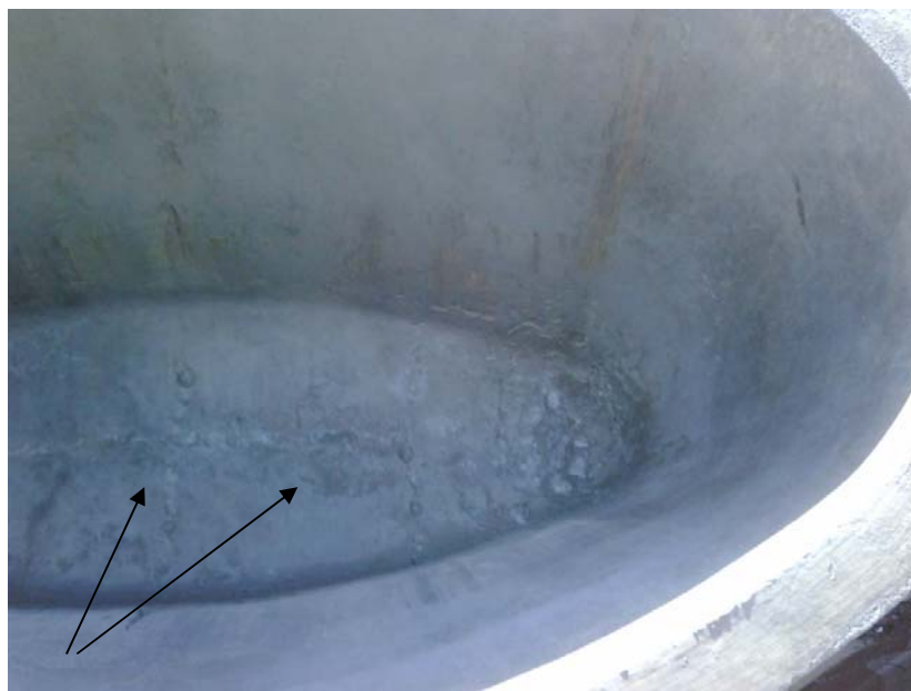
Figura 5 – Pote de Escória 09: Presença de cascões metálicos no fundo.
