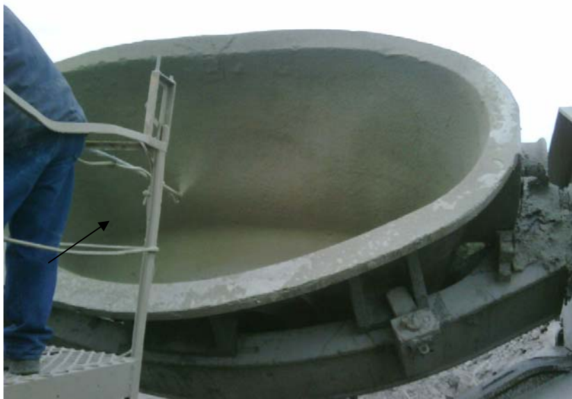
Figura 4 – Pote de Escória 01: Aspecto interno após aplicação do revestimento. Mesmo coberto com uma camada de produto, o defeito tipo “barriga” ainda pode ser identificado.
