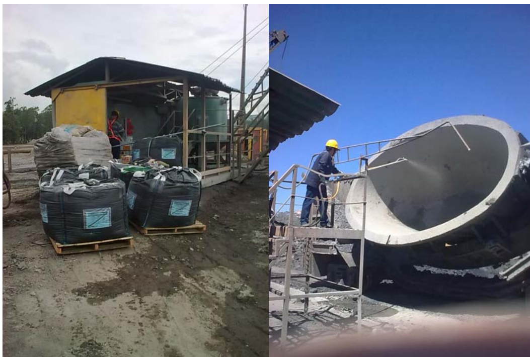
Figura 2 – Local utilizado para instalação da máquina de projeção por spray ou borrifamento, destacando plataforma utilizada como base para a aplicação.
