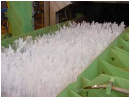
Fonte: Gerência de Manutenção Mecânica do Laminador – IAMT/ ArcelorMittal Tubarão. Figura 28 Vista do banco dos chuveiros inferiores regulados.
