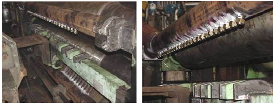
Fonte: Gerência de Manutenção Mecânica do Laminador – IAMT/ ArcelorMittal Tubarão. Figura 9. Instalação Chuveiros TBSC (Transfer Bar Skin Cooler – Resfriamento superficial).
