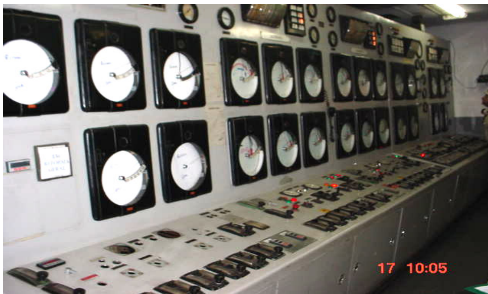
Figura 2. Painéis de controle originais da Central Termoelétrica.
