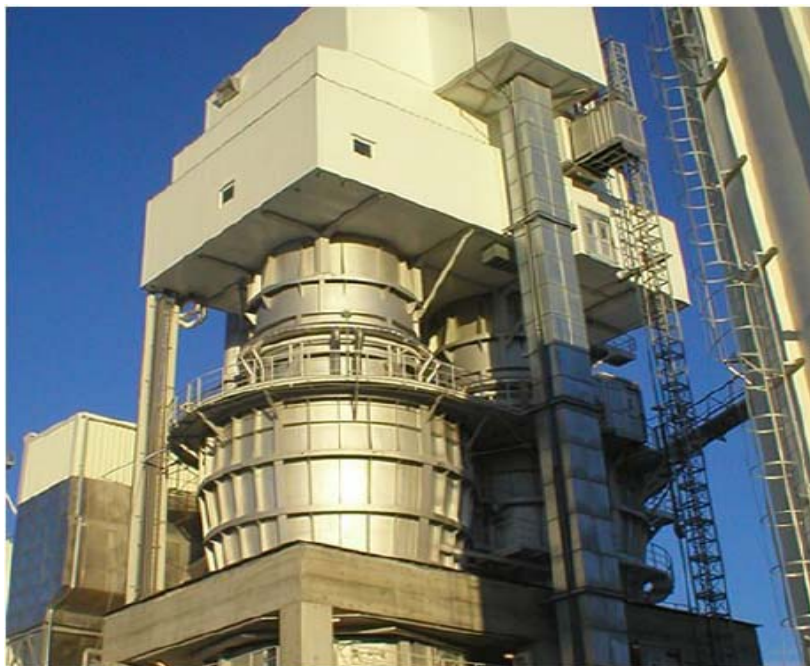
Figura 2 – Exemplo de forno vertical utilizado na calcinação 2 da ArcelorMittal Tubarão. (2)
