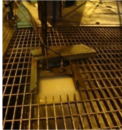
Figura 5 - Sensores instalados no tanque. (8)
