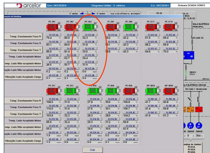
Figura 4- Monitoramento on-line de parâmetros operacionais dos motores.
