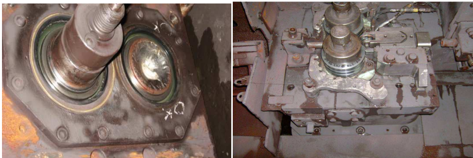
Gaiola com eixo quebrado
