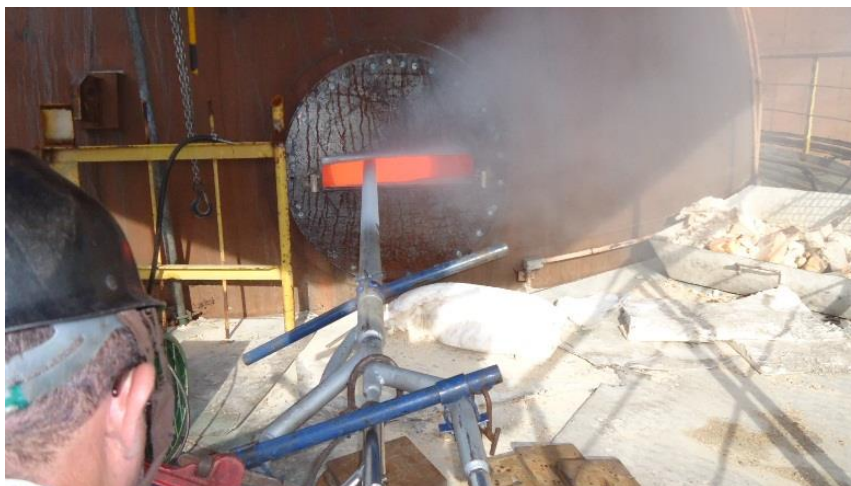
Figura 3. Aplicação de solda cerâmica no Regenerador 4 do Alto-forno 2 da Usiminas em Ipatinga.
