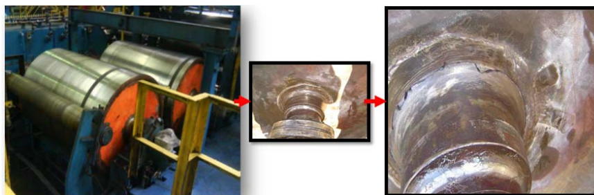
Figura 5b. Ilustração da falha crônica na junta soldada entre a manga do eixo e o espelho.
