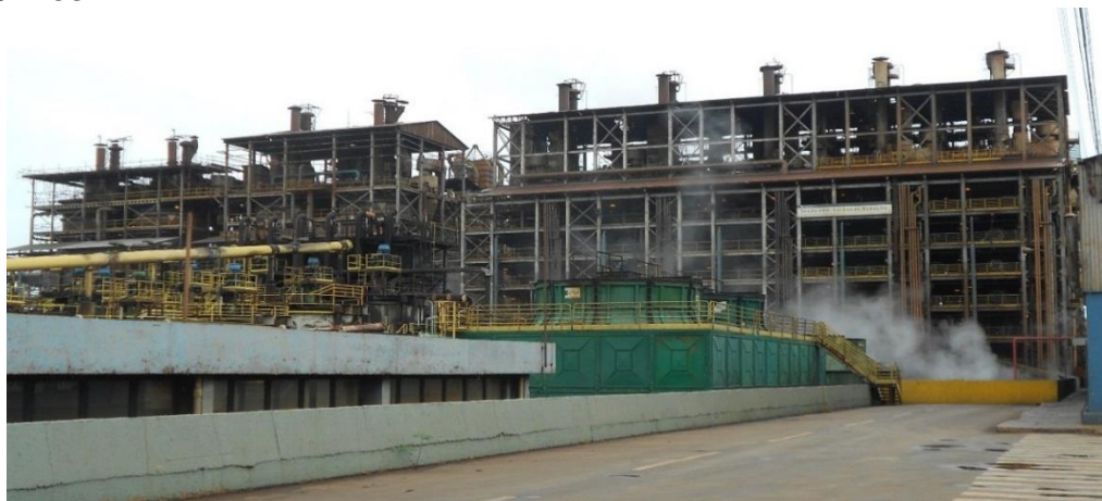
Figura 2 – Vista parcial dos fornos de redução
