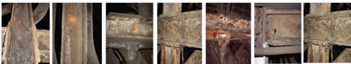
Figura 4. Corrosão da estrutura lateral dos veios do lingotamento contínuo 1 da ArcelorMittal Tubarão.
