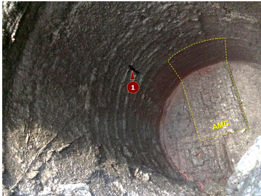
Figura 14. Fotografia da superfície do revestimento de uma panela de aço, após 92 corridas, evidenciando a abertura de junta vertical nos tijolos MAC1.
