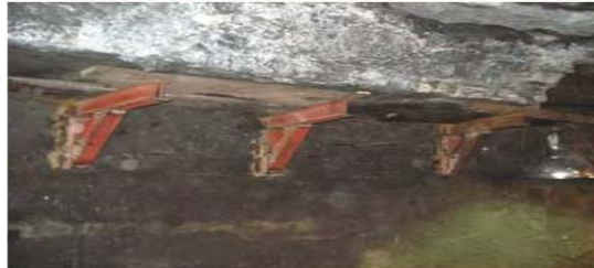
Figura 8. Estrutura de sustentação das fiadas de refratários das ventaneiras.
