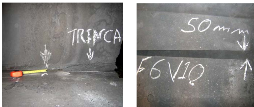
Figura 12. Trinca e deslocamento dos blocos de carbono.
