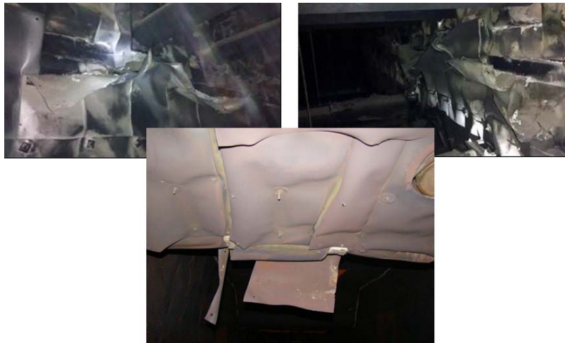
Figura 7- Chapas de inox da parede e teto com desgaste
