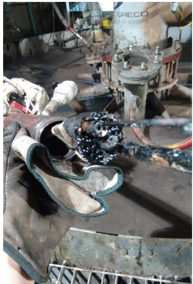
Figura 4: Acúmulo de óleo no Ignitor do GGQ.
