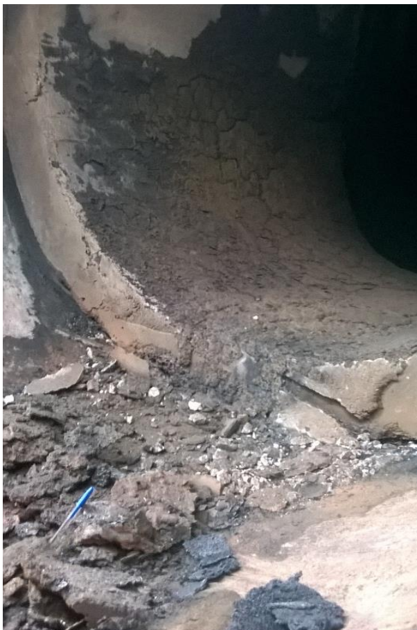
Figura 3: Acúmulo de borra oleosa nas tubulações após o Gerador de Gás Quente.
