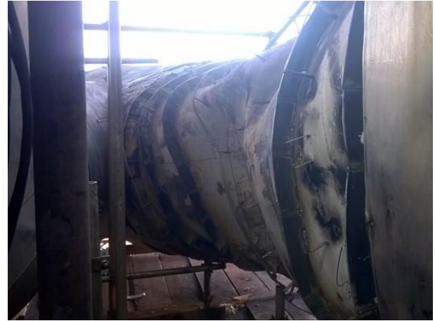
Figura 2: Danos na tubulação posterior ao Gerador de gás quente.
