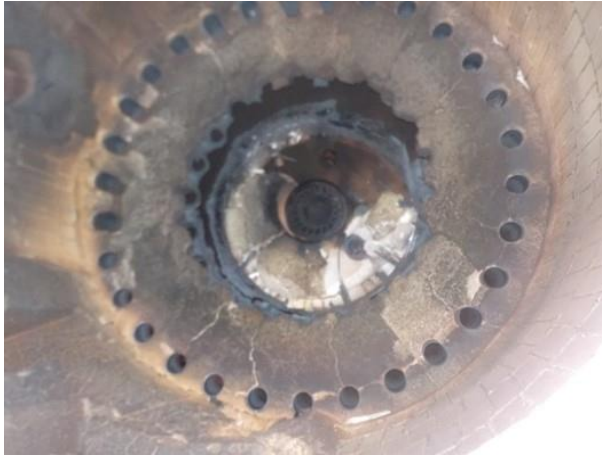
Figura 1: Danos no refratário do topo do gerador de gás quente.
