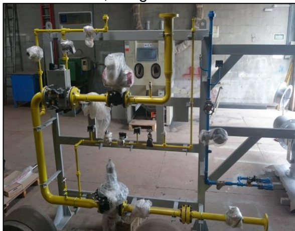
Figura 12: Cavalete de válvulas e instrumentos.
