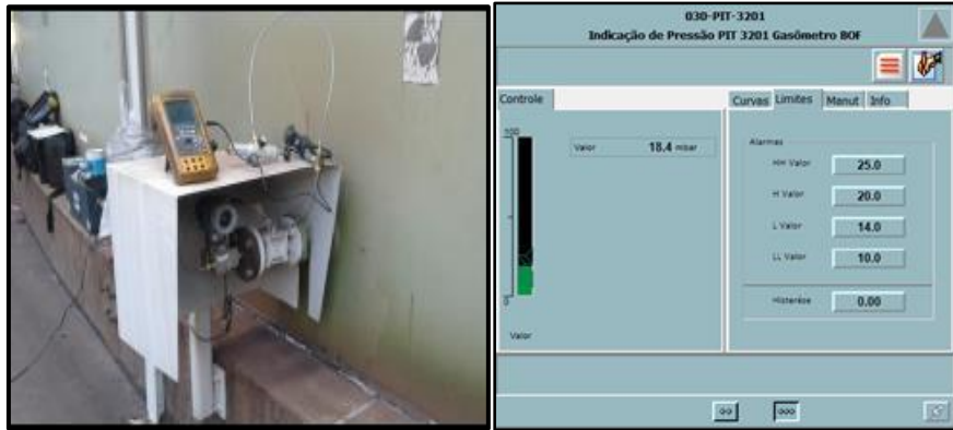
Figura 16. Aplicação de sinal no transmissor de pressão PIT-3201
