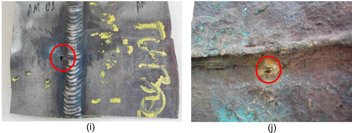
Figura 1 – Fenômeno de corrosão em estruturas metálicas de aços inoxidáveis da coqueria; destaca-se o ataque mais acentuado na região do cordão de solda e zonas de curvaturas de tubulações (fenômeno de impingimento).
