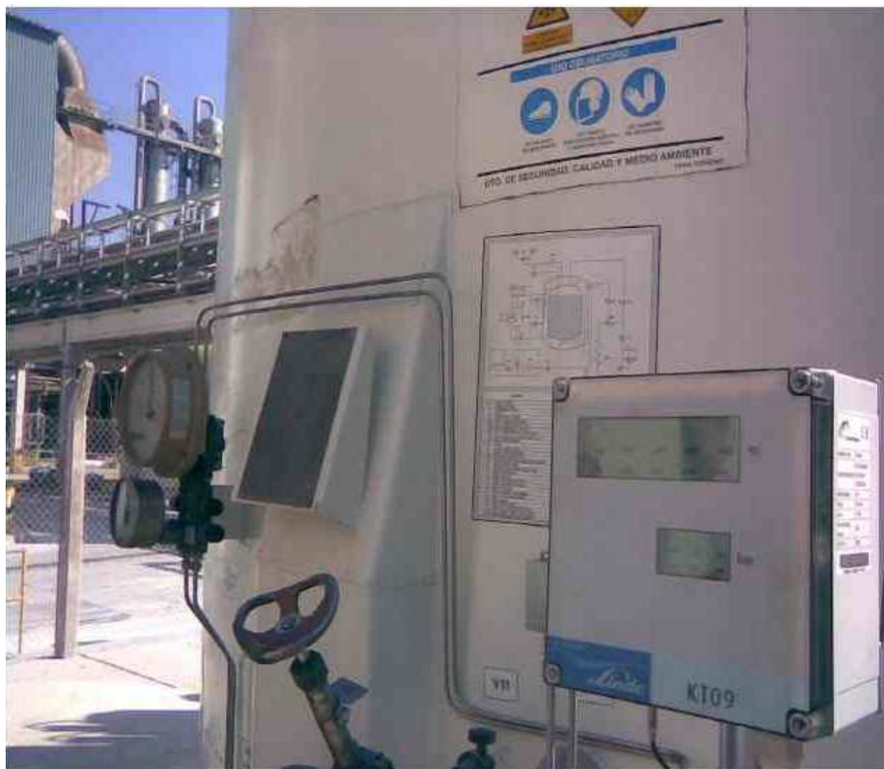
Figura 4 Fotografia de um Tanque Estacionário equipado com Telemetria.
