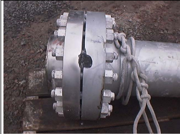
Figura 4. Dano provocado pelo vazamento na conexão dissimilar no flange do coletor de entrada.
