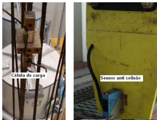
Figura 7 – Sensores instalados na ponte.
